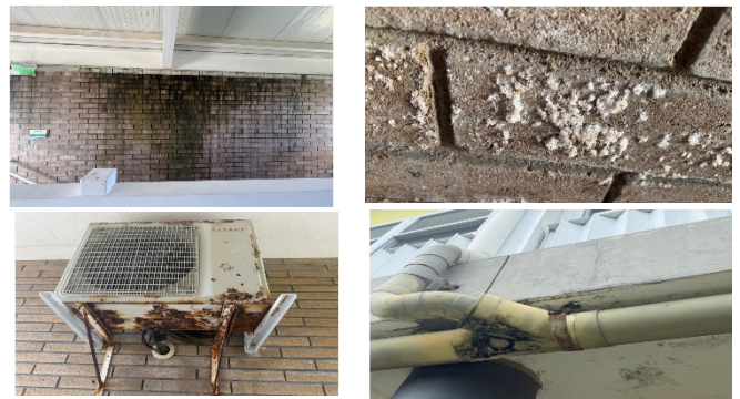
La desmejora y los daños que se presentan con la planta física
